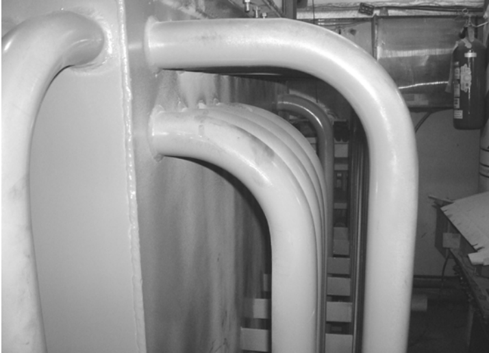
Fig. 9.4.1: Cuba de transformador con doble fila de tubos
