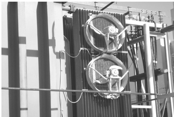
Fig. 9.6: Transformador de distribución con radiadores y ventilación forzada
